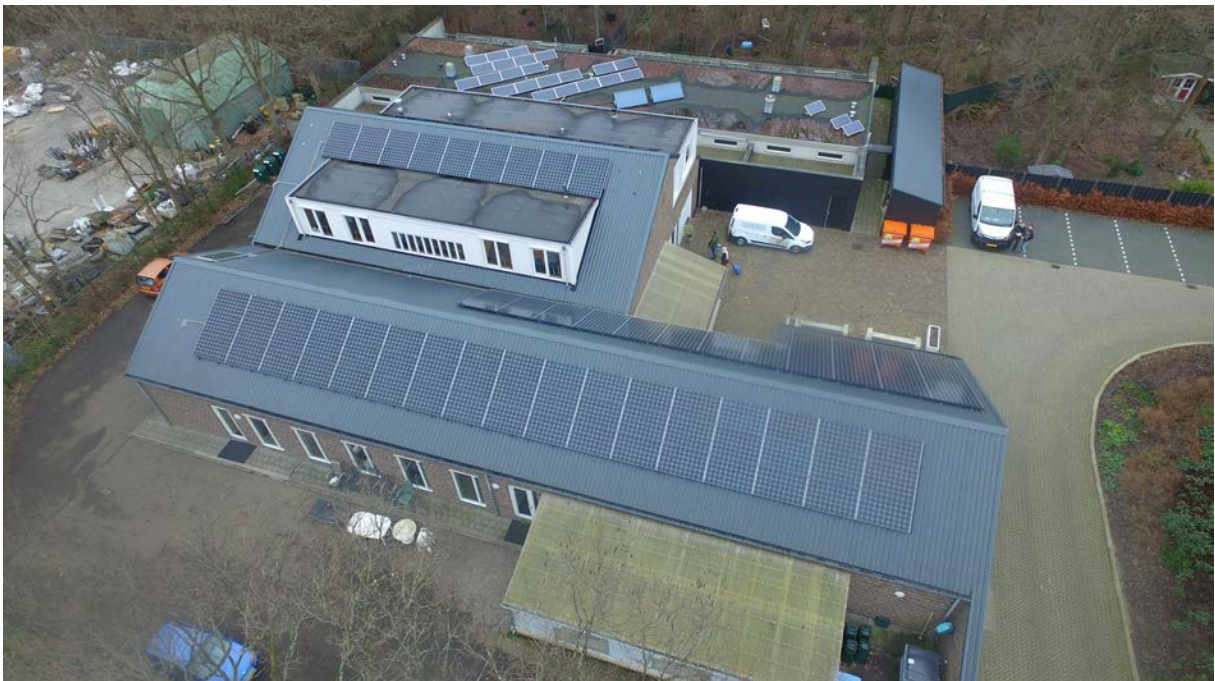
De nieuwe zonnepanelen op de schuine daken van Dierentehuis Stevenshage in Leiden. Op het platte dak achteraan de bestaande panelen en de collectoren voor de zonneboilers. Foto: Solar-Energy-Groep
